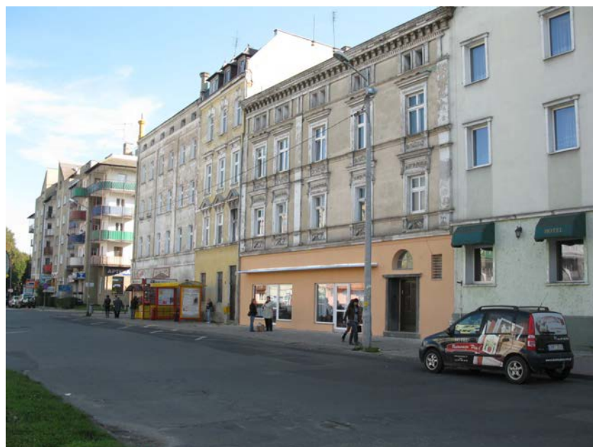
W M „Piaś” ul.Piastowska 2,4,6 ul.Kr.Jadwigi 7 elewacja oczekująca na remont
